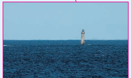
貝殻島は納沙布岬の北東沖合3.7kmに位置し、北方領土の島の中では最も日本本土に近い。昭和12年に日本が建設した貝殻島灯台があり、灯台基部と共に基礎部分の劣化が進み、傾いた姿が納沙布岬から目視で確認できる。
